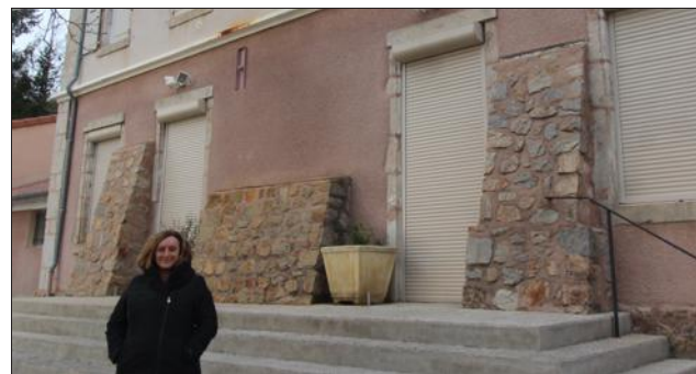
Ghislaine Chambon indique que c'est dans ce bâtiment communal Alliandre que sera changée la chaudière fuel contre une chaudière à granulés bois.
